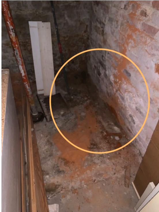
Markering av fuktinträning golv. Förråd i källare under Vegagatans trapphus.
