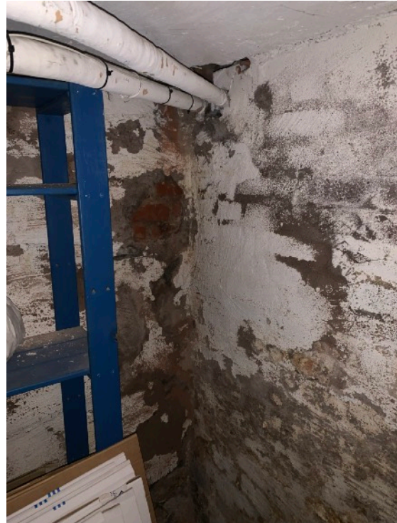
Bild visar källarvägg och innervägg i förråd under skadeområdet. Väggen är fuktbelastad och innehåller material som medför fuktuppsug (t.ex. tegel).
